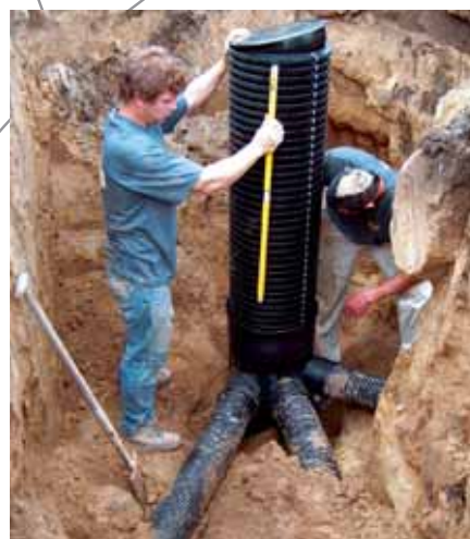
Puits avec les 3 tuyaux horizontalement décalés
